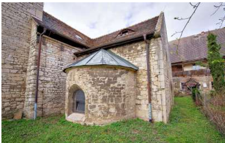
Besondere Blicke und Einblicke ermöglicht die Sakristei der Zscheiplitzer Klosterkirche nach umfangreichen Arbeiten. Der nördliche Teil des Gotteshauses, das seit 2017 zur Straße der Romanik zählt, war um 1220 errichtet worden.
